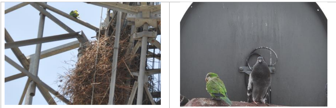
Figura 34. Nido en antena de telecomunicaciones y depósito de guano en cables y parabólica por pericos y palomas.
